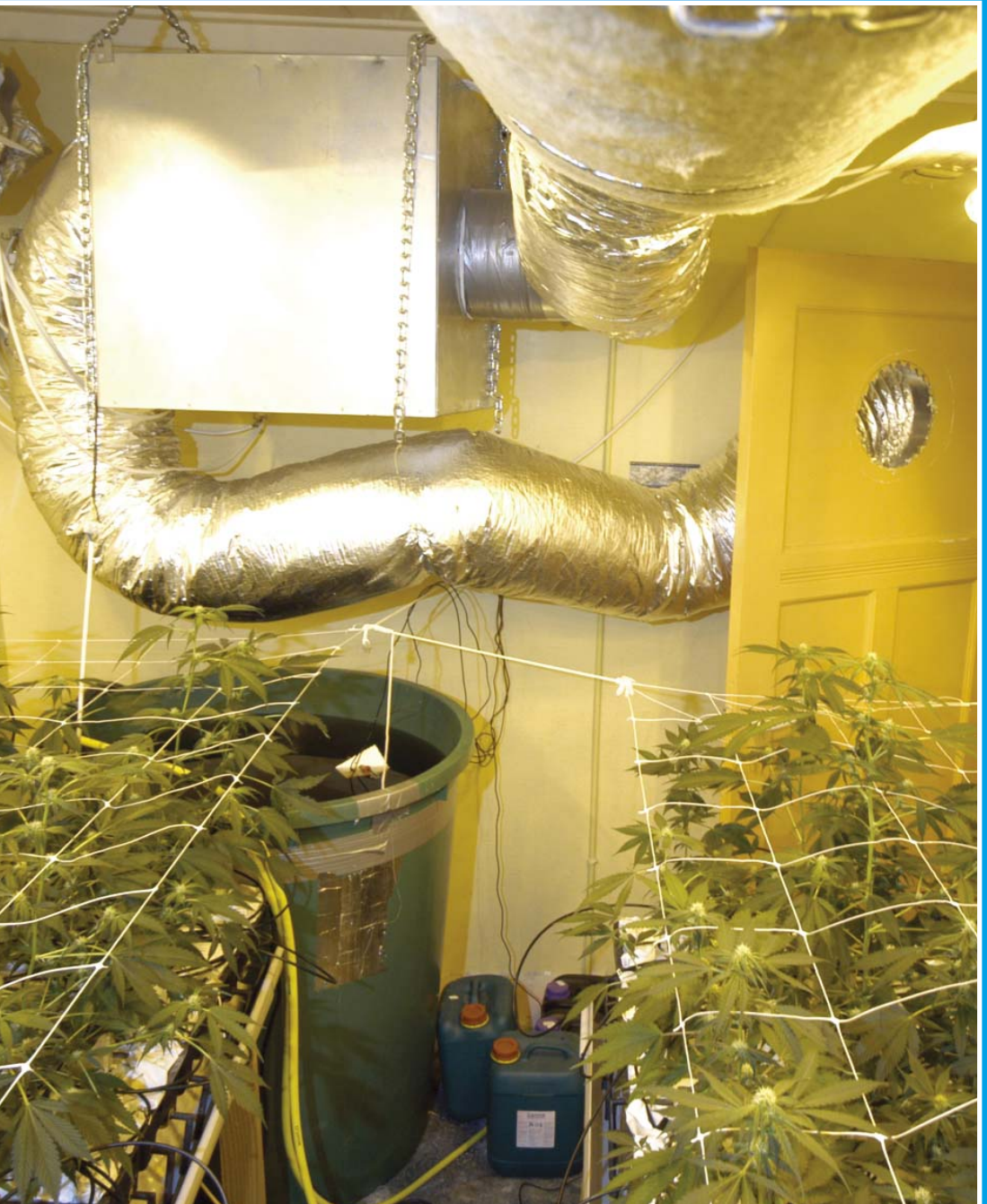
Un filtro de carbono y una caja de intercambio con ozono dominan la vista de este cuarto holandés de cultivo.
